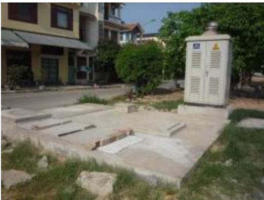
Trạm bơm nước thải
