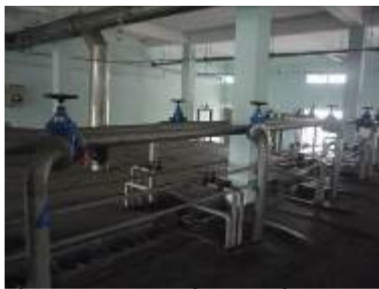
Hệ thống hút mùi về hệ thống xử lý khí
