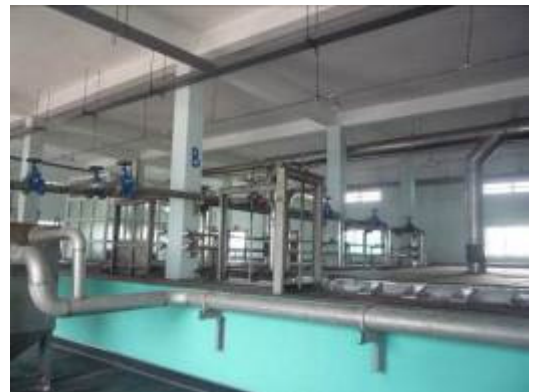
Hệ thống tiền xử lý trong nhà máy XLNT Đức Ninh (Bể lắng cát, song tách rác, hệ thống hút mùi và xử lý mùi)
